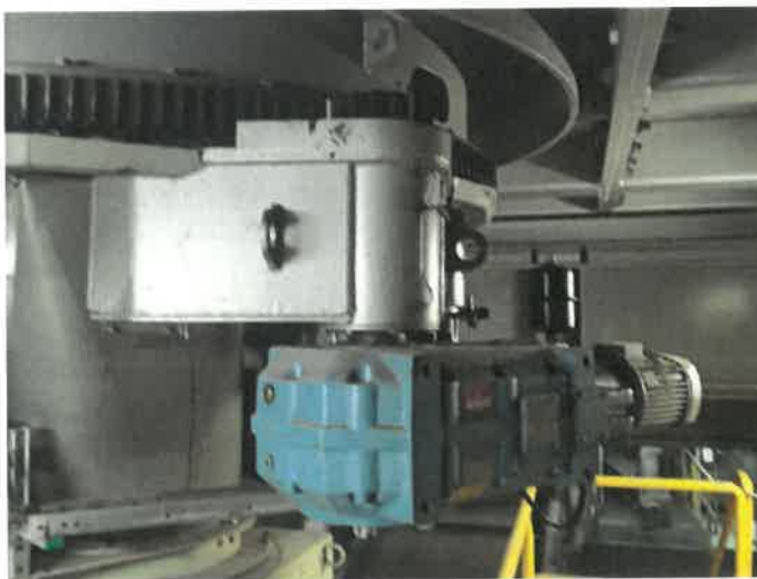
Rys. nr 6.13.21. Widok wieńca zębatego pierścienia obrotowego na bloku
